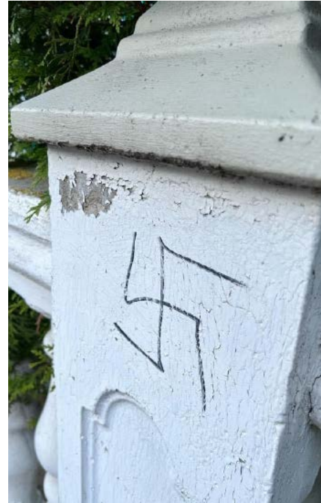
22.09.2022: An die Außenfassade der Moschee wurde ein Hakenkreuz geschmiert.
